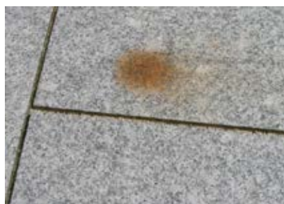
Rostiger Splitt im Unterbau
